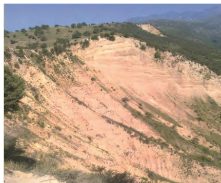
Рис. 6. Оползень в Аркутсае (Ташкентская область)
